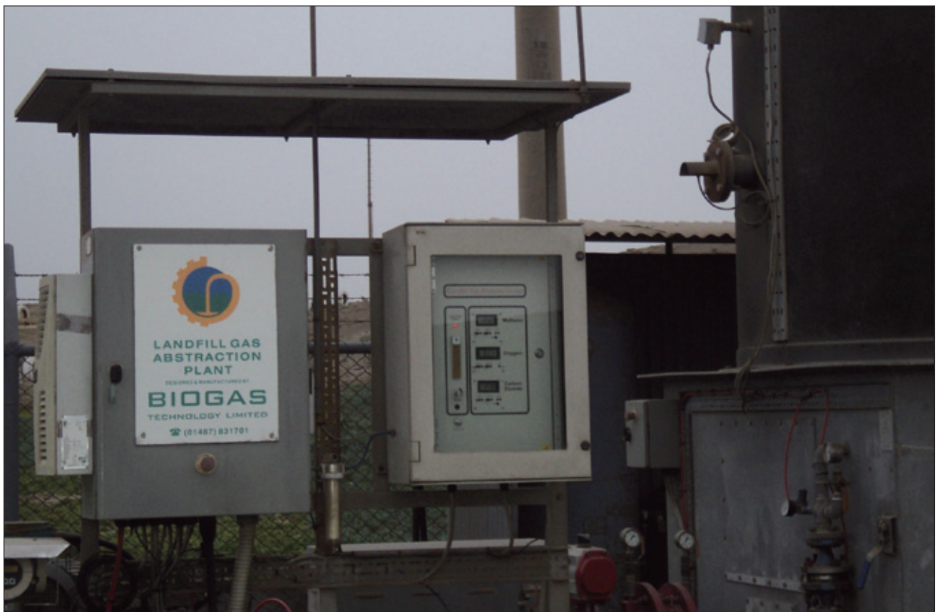
Foto 8. MDL Planta de Biogas Ancón.
